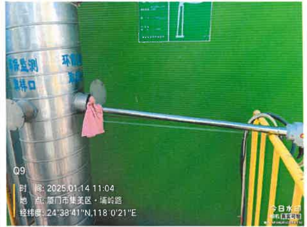
105C 磨白字车间废气排气筒出口(点位:◎9)
