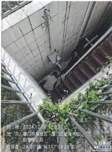
污水站总排口
