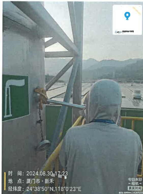
102 押延车间排气筒出口
