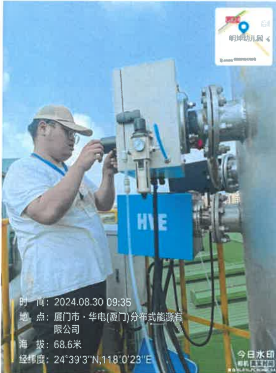
101A 混炼车间 1号排气筒出口
