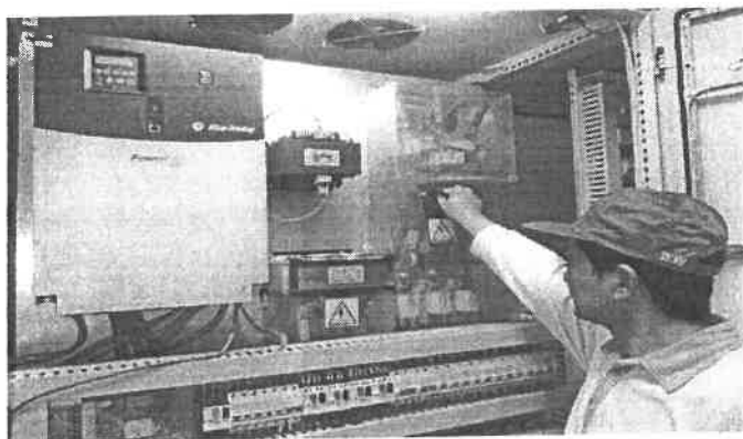
3. 拉掉总闸，切断电源
