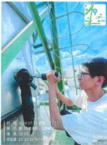
504 车间硫化车间排气筒出口 DA029 (25 号排气筒)
