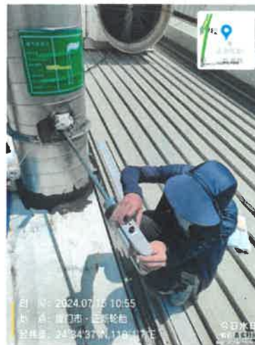
303 车间硫化车间排气筒出口 DA045 (18 号排气筒)
