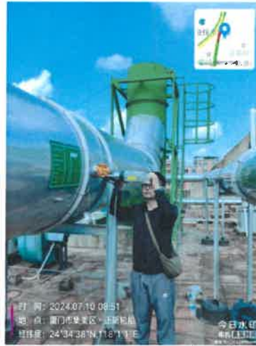
07 车间硫化车间排气筒出口 DA059 (59 号排气筒)
