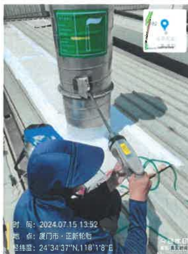
303 车间硫化车间排气筒出口 DA046 (16 号排气筒)
