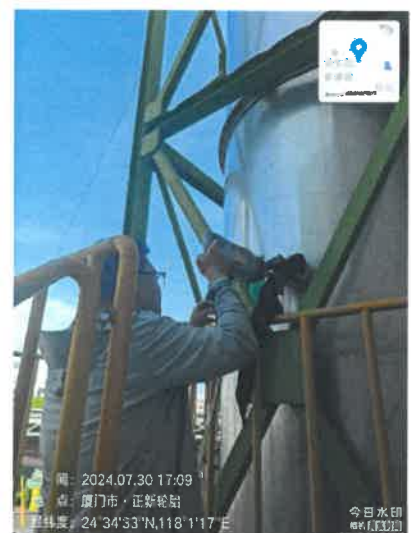
701 炼胶车间排气筒出口 DA014 (3号排气筒)
