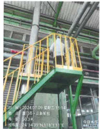
08 硫化洗模车间排气筒出口 DA061 (61 号排气筒)
