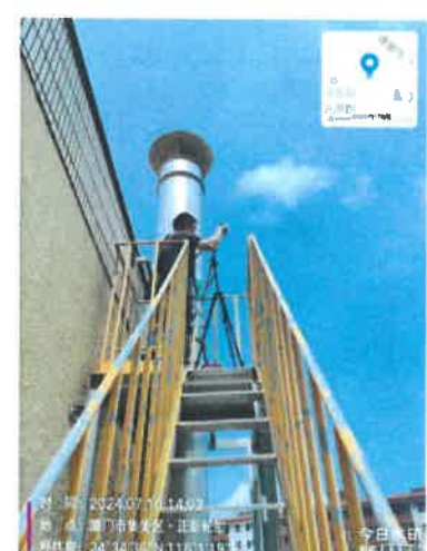
14 配药车间排气筒出口 DA055 (51 号排气筒)
