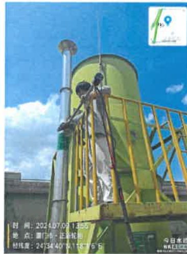
05 硫化洗模车间排气筒出口 DA063 (63 号排气筒)
