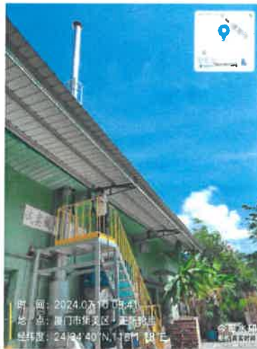
木工房洗模车间排气筒出口 DA060 (69 号排气筒)
