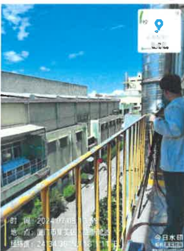
502 成型车间排气筒出口 DA007 (39 号排气筒)
