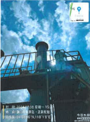
302 成型车间排气筒出口 DA009 (36 号排气筒)
