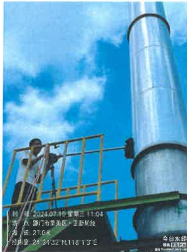
202 成型车间排气筒出口 DA004 (42 号排气筒)
