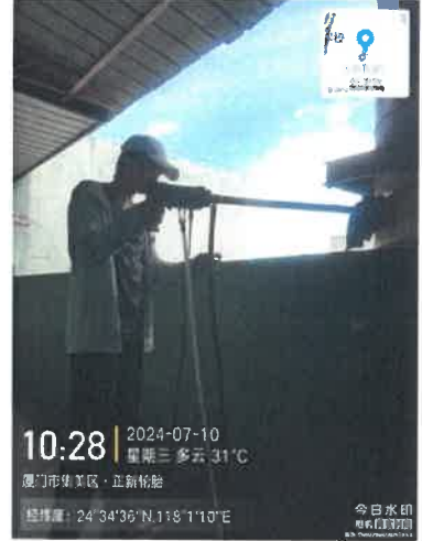
502 成型车间排气筒出口 DA005 (38 号排气筒)
