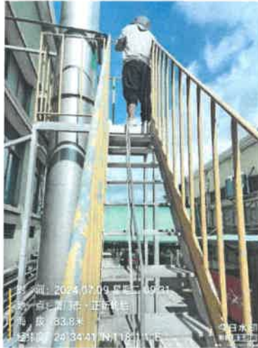
04 成型车间排气筒出口 DA002 (32 号排气筒)
