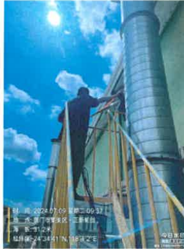
04 成型车间排气筒出口 DA012 (34 号排气筒)
