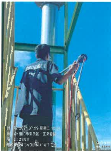
303 硫化洗模车间排气筒出口 DA065 (65 号排气筒)
