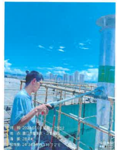
504 硫化洗模车间排气筒出口 DA064 (64 号排气筒)
