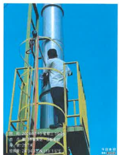
306 成型车间排气筒出口 DA011 (41 号排气筒)
