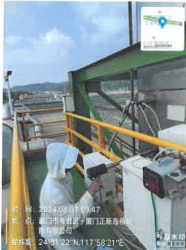
105/205 硫化车间 1#硫化排 气筒出口 (DA004)
