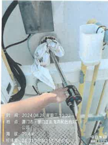
501 混炼车间排气筒出口 (DA003)
