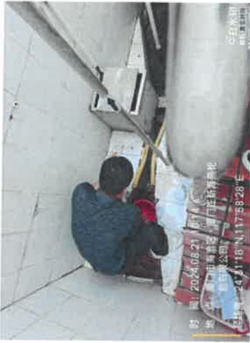
污水站总排口
