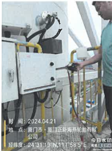
501 混炼车间排气筒出口 (DA003)
