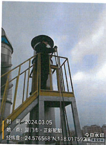
504 检修车间排气筒出口 DA018 (厂内编号 DA046)
