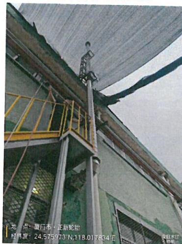
203 检修车间排气筒出口 DA021 (厂内编号 DA048)
