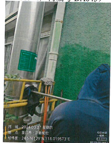
502 检修车间排气筒出口 DA022 (厂内编号)
