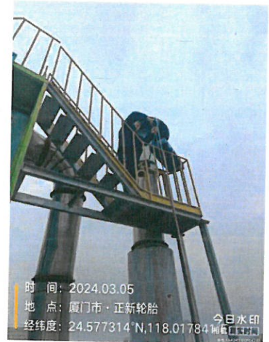
304 检修车间排气筒出口 DA019 (厂内编号 DA045)
