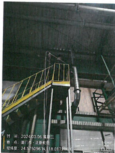
204 钢丝车间排气筒出口 DA023 (厂内编号 DA050)
