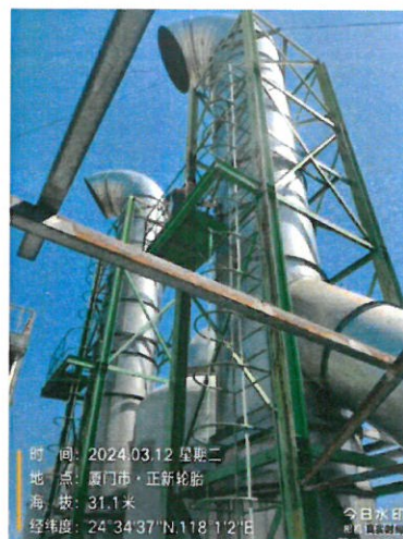
504 车间硫化车间排气筒出口 DA029 (厂内编号 DA025)
