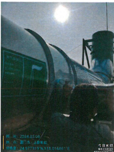
研发技术楼废气排气筒出口 DA059 (厂内编号 DA059)
