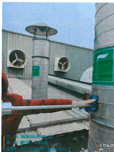
303 车间硫化车间排气筒出口 DA038 (厂内编号 DA010)
