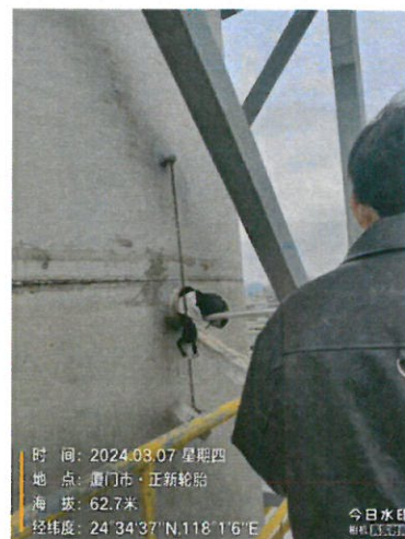
303 车间硫化车间排气筒出口 DA058 (厂内编号 DA057)
