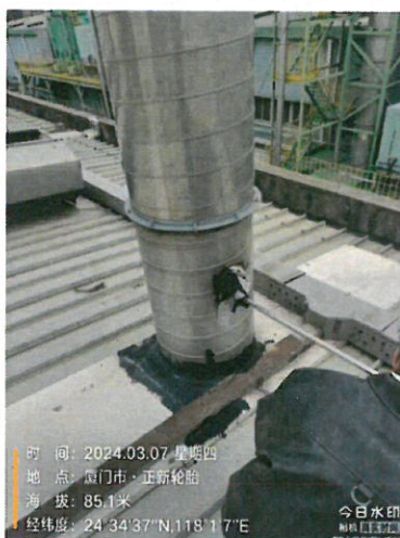
303 车间硫化车间排气筒出口 DA047 (厂内编号 DA019)
