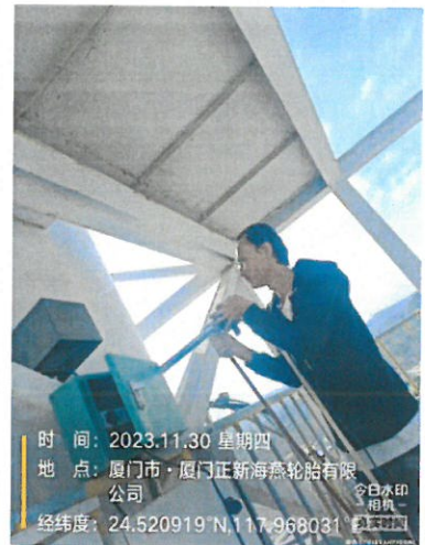
301 混炼车间排气筒出口 (DA002)
