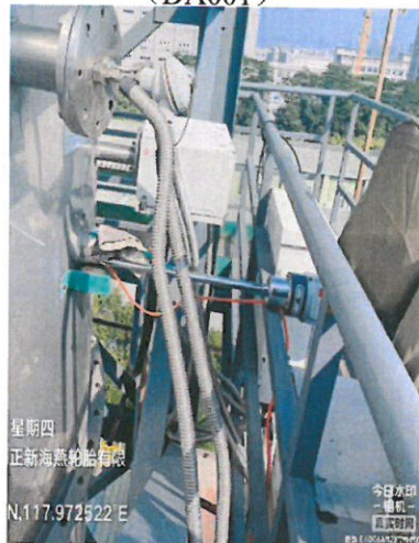
105/205 车间硫化车间排气筒 出口 (DA004)
