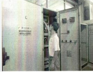
5、主管对各机台电源进行闭关。
